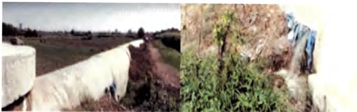
Los agricultores en Víctor Larco-Buenos Aires utilizan el agua indebidamente, dañando la infraestructura de colectores de red de alcantarillado para regadío de sus cultivos.
