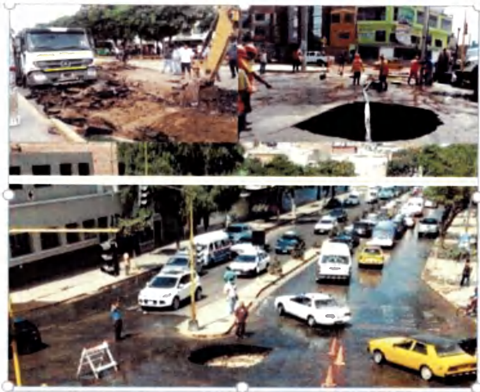
AV. JUAN PABLO II, TRAMO DEL SISTEMA DE ALCANTARILLADO SANITARIA TOTALMENTE COLAPSADO PRODUCTO DE LA ANTIGÜEDAD DE SUS TUBERÍAS Y POR LA SOBREPRESIÓN DEBIDO A LAS INTENSAS LLUVIAS OCURRIDAS EN LA CIUDAD DE TRUJILLO
