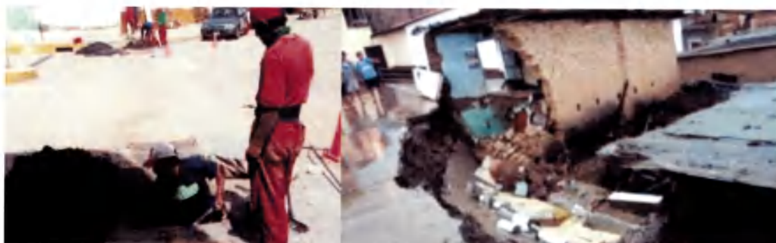
DESAGÜES DE MÁS DE 40 AÑOS EN RIESGO DE COLAPSAR POR LLUVIAS: UN POSIBLE COLAPSO DE LAS TUBERÍAS DE DESAGÜE TEMEN LOS POBLADORES DE LA PROVINCIA LIBERTEÑA DE CHEPÉN TRAS LAS CONSTANTES LLUVIAS QUE VIENEN AFECTANDO
